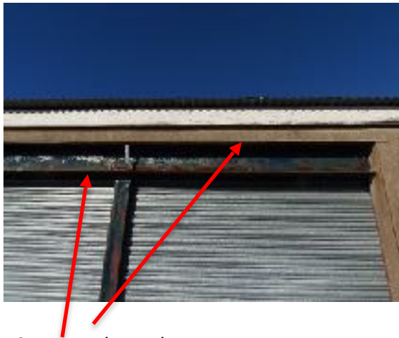
B2 – gaps above door
