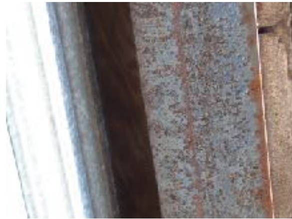
B2 – gaps above door
